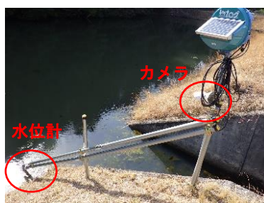
遠隔監視装置 （カメラ・水位計付）
