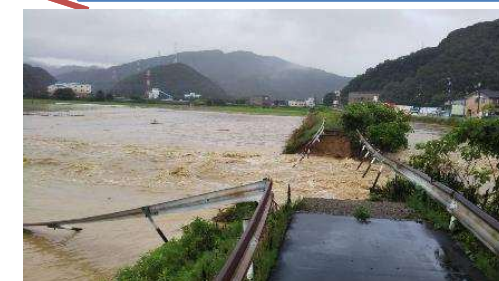
天井川における破堤(三原市)
